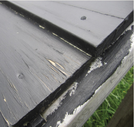
État d’un bardage en pin Radiata traité par préservation (qualité sans nœuds) avec finition noire après 3 ans d’exposition aux intempéries.
